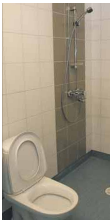
Kylpyhuoneen ilmanvaihdoista on pidettävä huolta.
